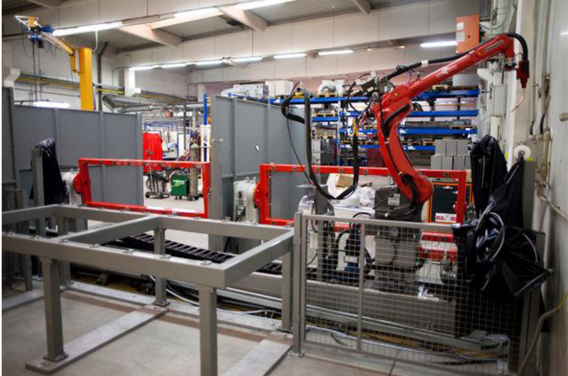
Obr. 7.1 Robotické svařovací pracoviště ve společnosti Hestego a.s.
