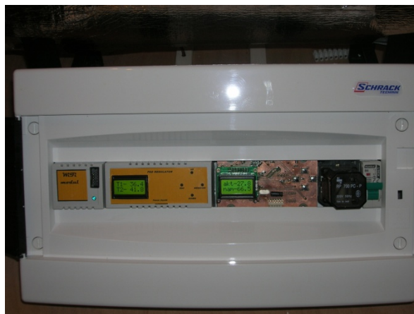
Fotka 8 : Rozvaděč MaR
