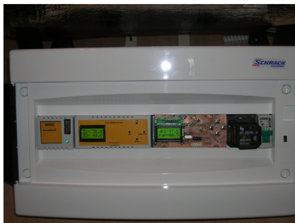
Fotka 8 : Rozvaděč MaR
