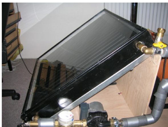
Fotka 5 : Zapojený solární panel
