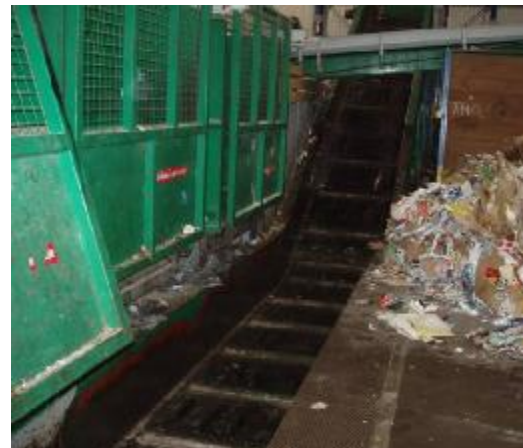
Obr. 34: Plnicí dopravník lisu-rovná část
