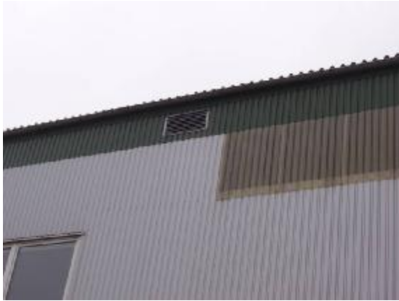
Obr. 46: Nasávání přiváděného vzduchu
