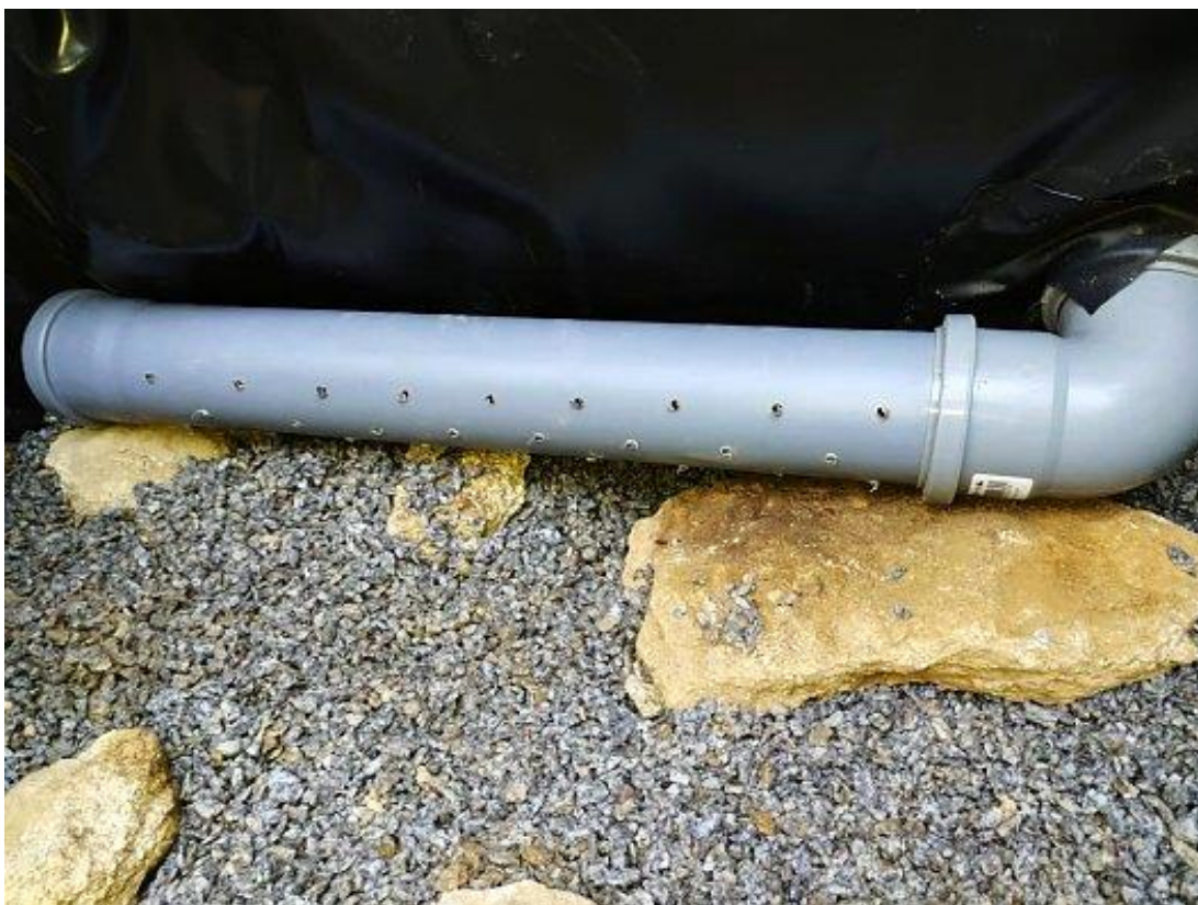
Obrázek 61: Distribuce vody do KČOV skrz nátokové potrubí.
