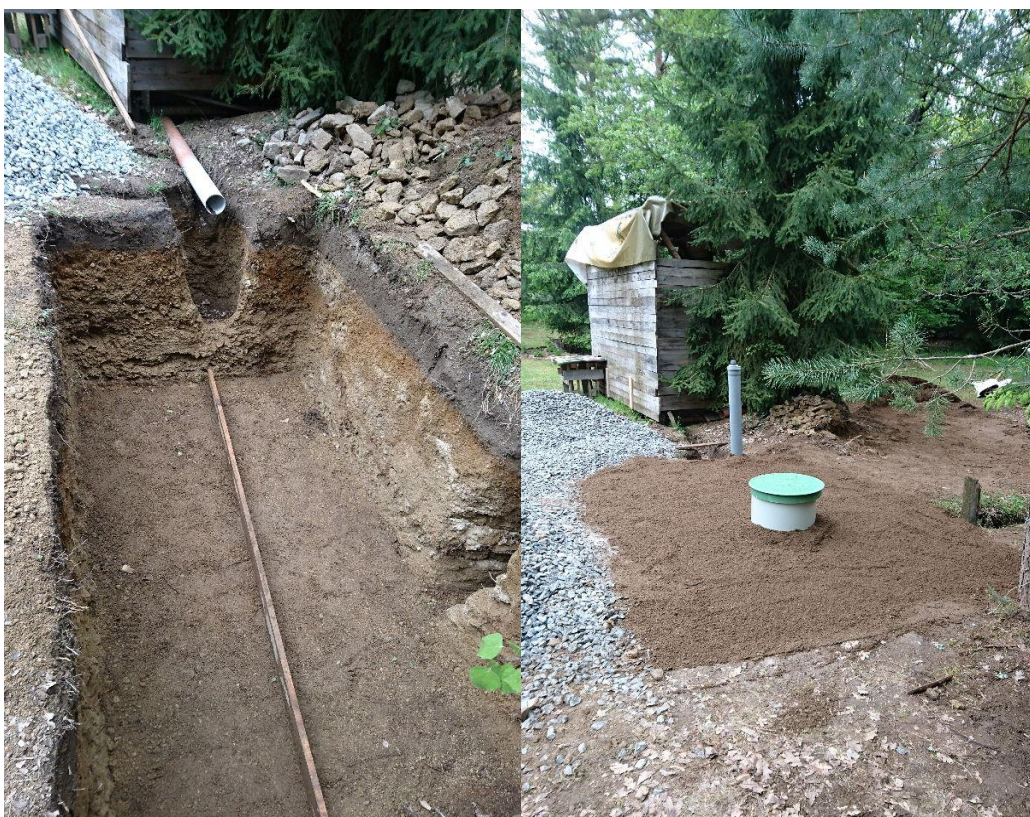
Obrázek 18: Realizace experimentálního zemního pískového filtru, vlevo výkopové práce před usazením filtru, vpravo finální úprava po usazení.
