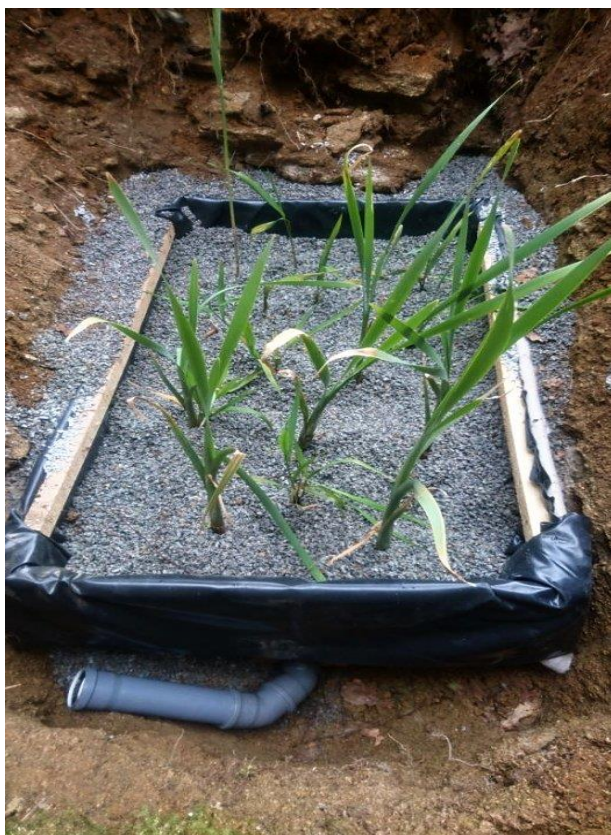
Obrázek 20: Vysazení orobince do připraveného štěrkového lože. V popředí stavitelný odtok, na regulaci výše hladiny vody v KČOV.
