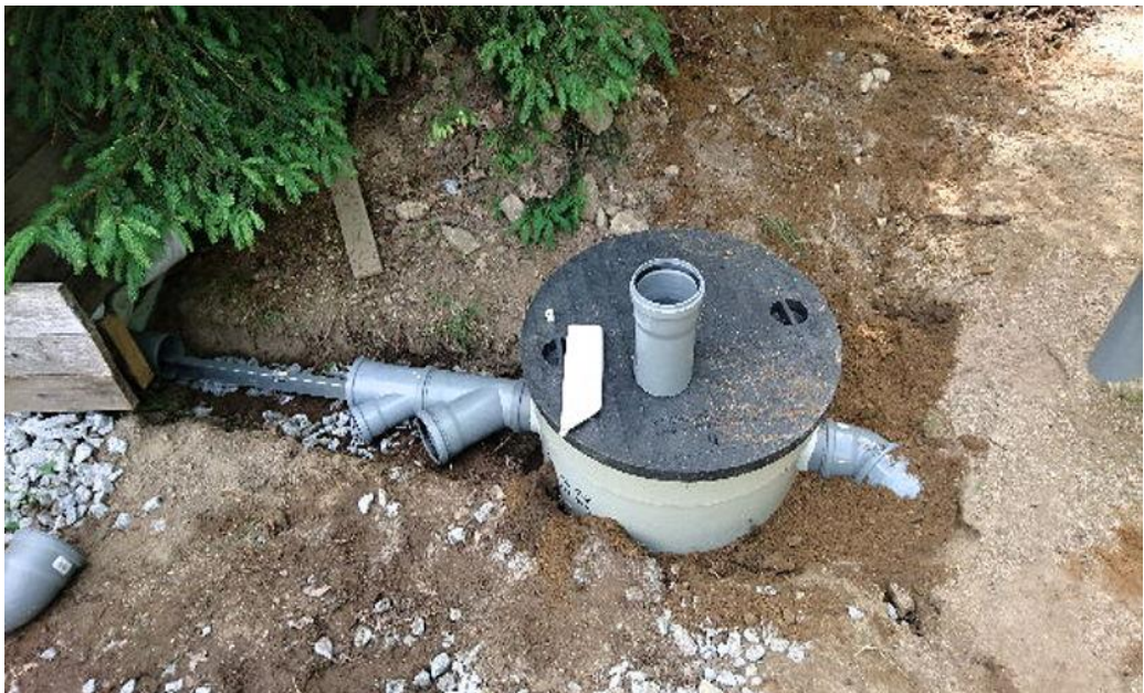
Obrázek 50: Instalace odkalovací nádoby.
