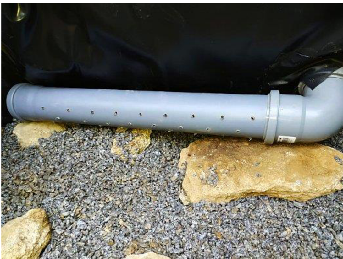
Obrázek 61: Distribuce vody do KČOV skrz nátokové potrubí.
