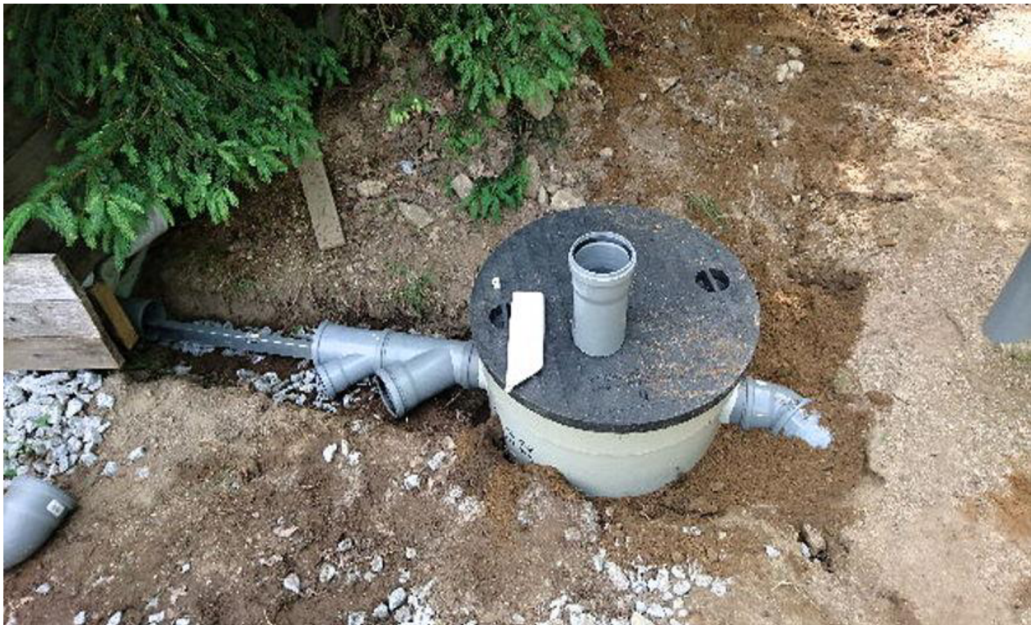
Obrázek 50: Instalace odkalovací nádoby.
