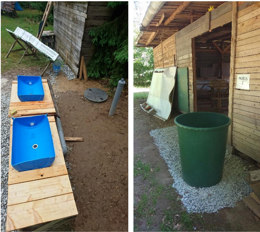
Obrázek 53: Napojení všech provozů k zemnímu pískovému filtru a ukázka drenáže pro odvodnění vody ze střechy.
