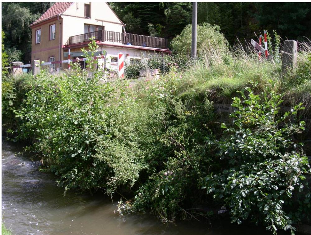
Obrázek 23 Nábřežní opěrná zed' Úštěk – havárie, nábřežní zed' nahrazena již vzrostlými křovinami.
