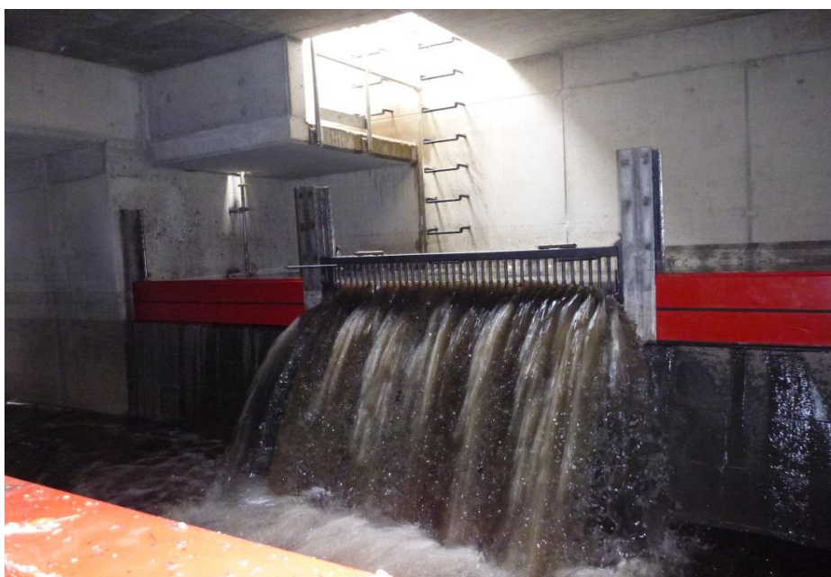
Obr. 15 Přepad odpadních vod z kmenové stoky A při srážkové události do retenční nádrže Sokolova (soukromý fotoarchiv autora)
