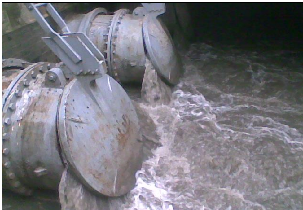
Obr. 5 Přepad odpadních vod z odlehčovací komory (soukromý fotoarchiv autora)
