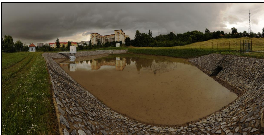
Obr. 7 Otevřená (nadzemní) retenční nádrž v Brně – Líšeň (Brněnské vodárny a kanalizace, a. s., 2010)
