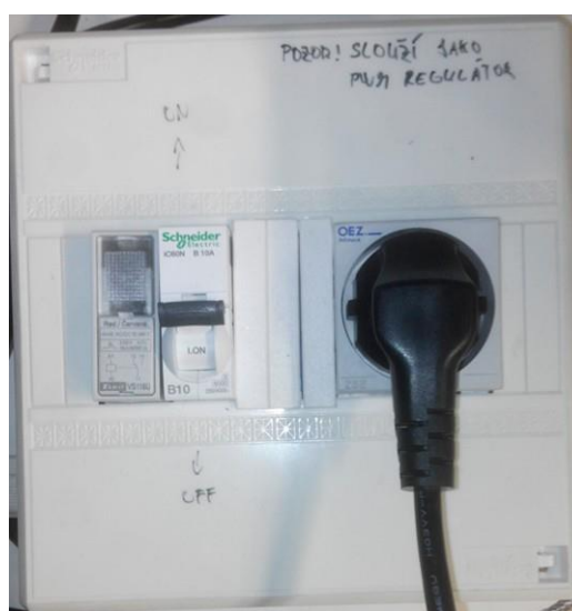
Obr. 40: Rozvaděč s jističem a spouštěcím relé.
