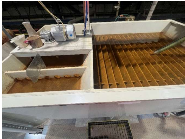
Obr. 16. Fotografie flokulační komory
