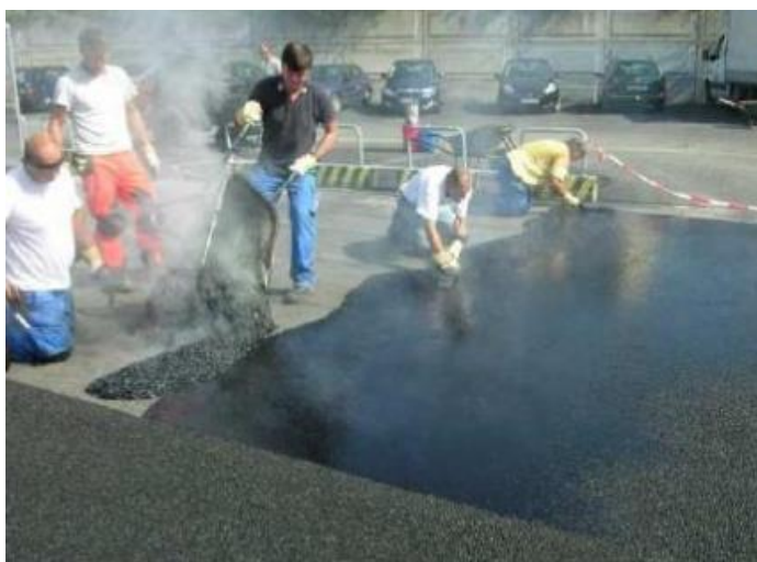
Obr 9.5: rozprostírání vrstvy Litého Asfaltu (příklad hrubého porušení BOZP)
