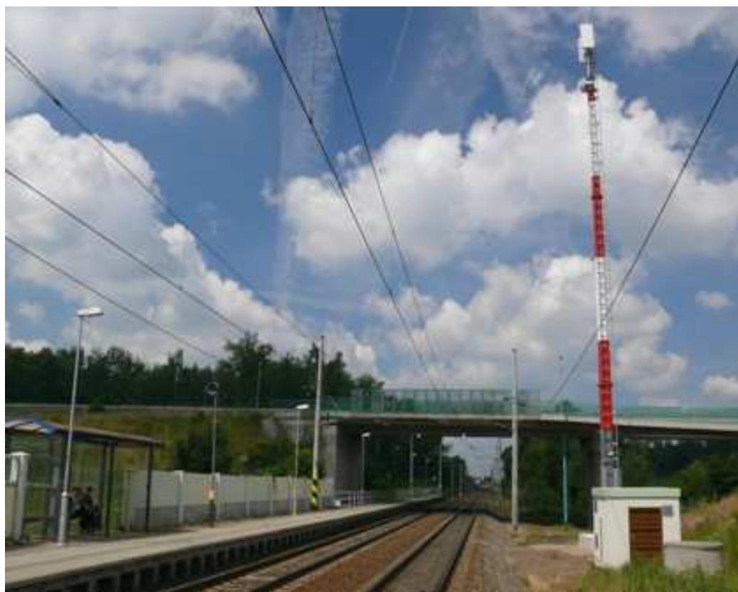
Obrázek č. 26: Umístění BTS stanice podél trati
