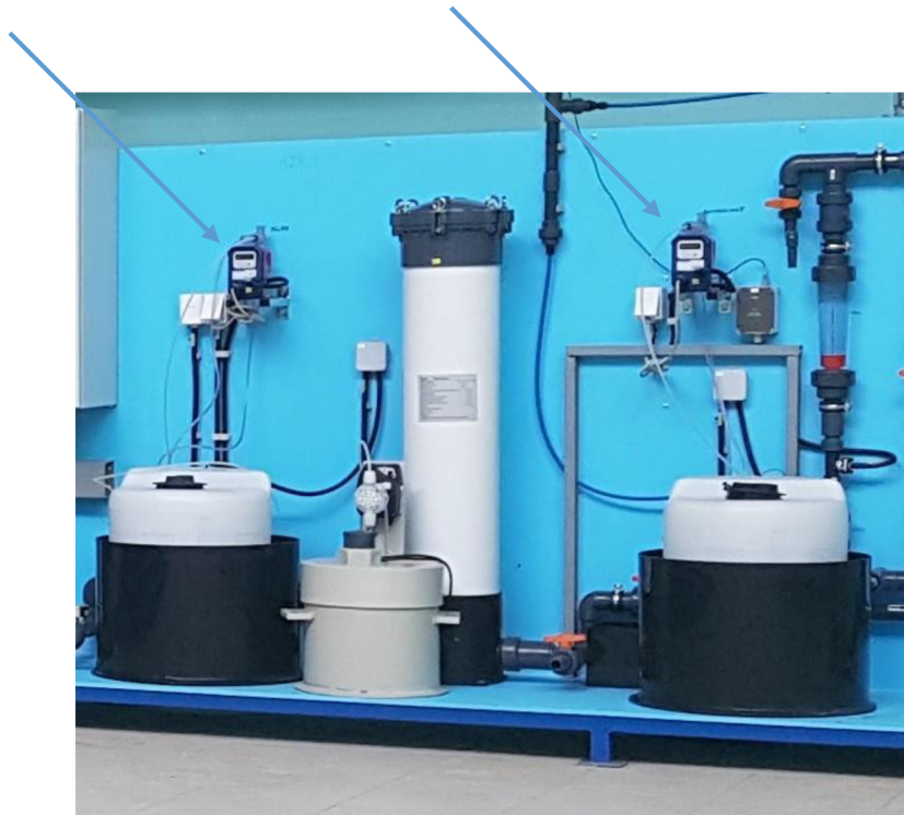
Obr. 5 Automatické dávkovače na chemii (WATERLife, 2023)
