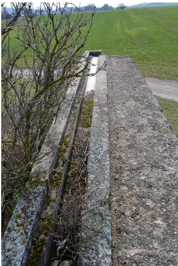
Obr. 79 Odvodňovací systém na okraji mostu (M. Sedlák, březen 2019)
