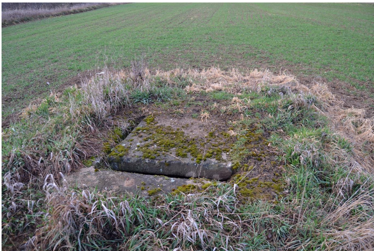
Obr. 88 Středová kanalizace (M. Sedlák, březen 2019)
