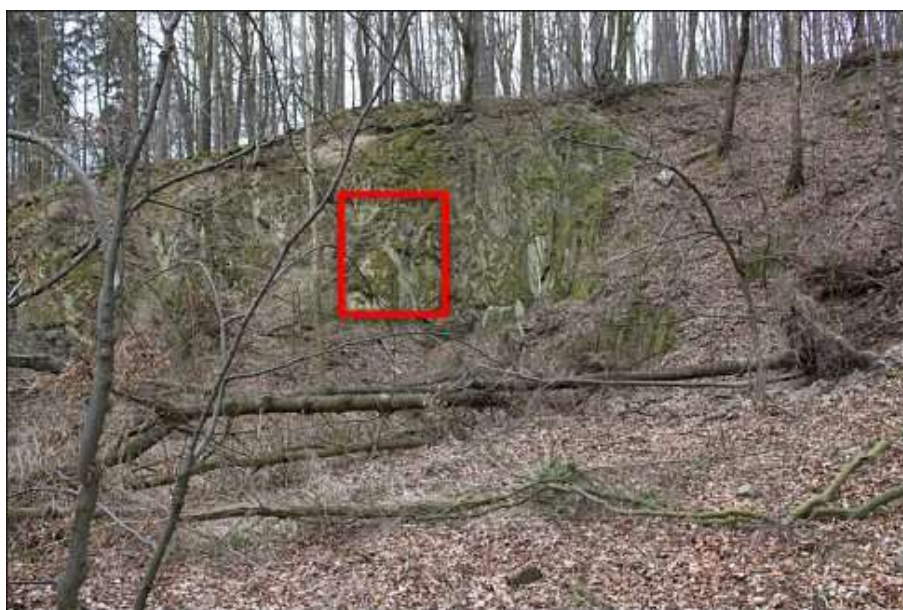
Obr. 8.11: Lomová stěna o místem odběru vzorku, pohled ze severu na jih (8.4.2018).
