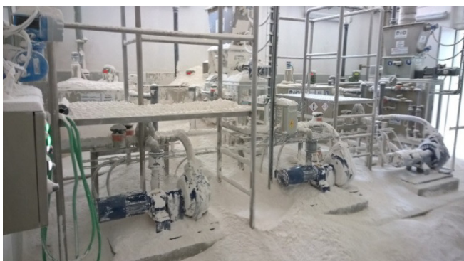
obr. 49 Závada v komunikaci mezi centrálním SŘTP a dílčím SŘTP vápenného hospodářství (SčVK 2016)
