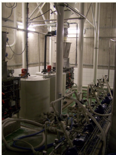
obr. 29 Dávkování vápenného hydrátu - vlastní foto 2018
