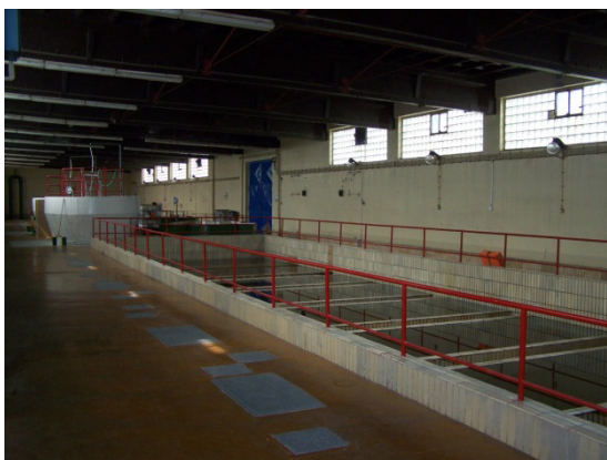
obr. 37 Nová filtrace – vlastní foto 2018
