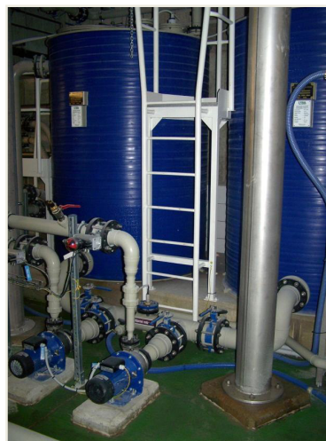
obr. 30 Dávkování vápenné vody – vlastní foto 2018
