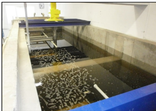
obr. 43 Reakční nádrž – vlastní foto 2018
