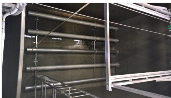
obr. 51 ÚV Meziboří – dno flotační nádrže (SČVK 2016)
