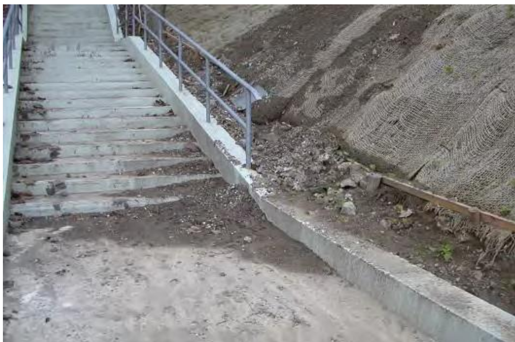
Obrázek 16. Eroze pod geotextilií (Zlatuška 2013).
