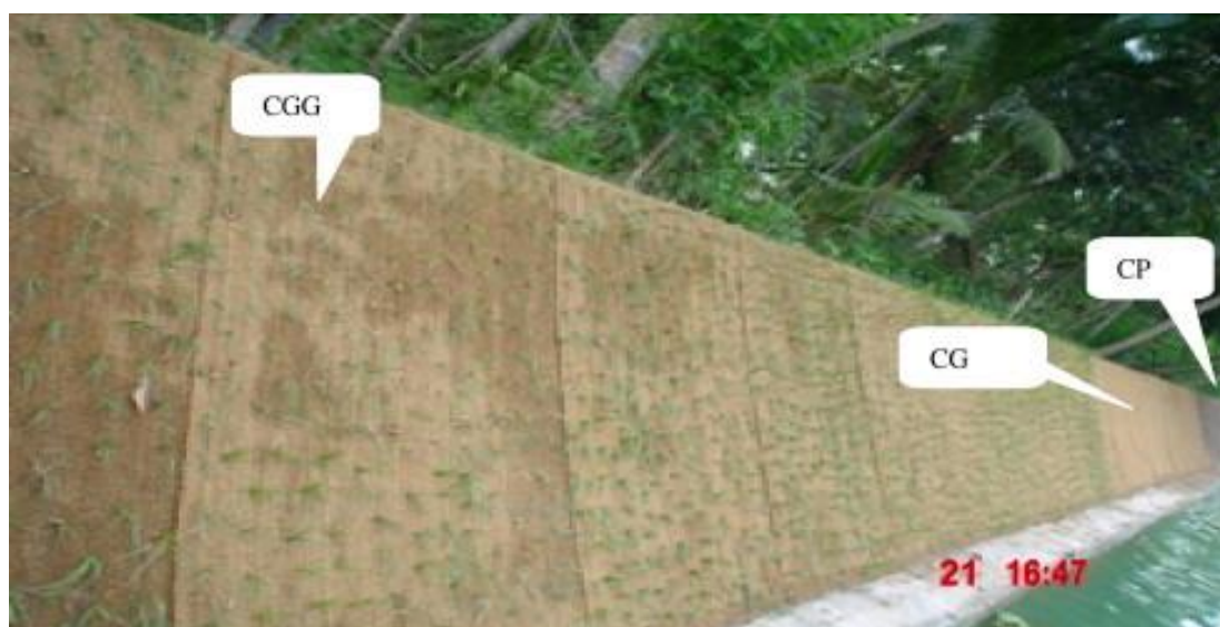
Obrázek 10. Aplikace geotextilií na břehy rybníka (Vishnudas et al. 2008). CGG – geotextilie s výsadbou, CG – pouze geotextilie, CP – neošetřený břeh.
