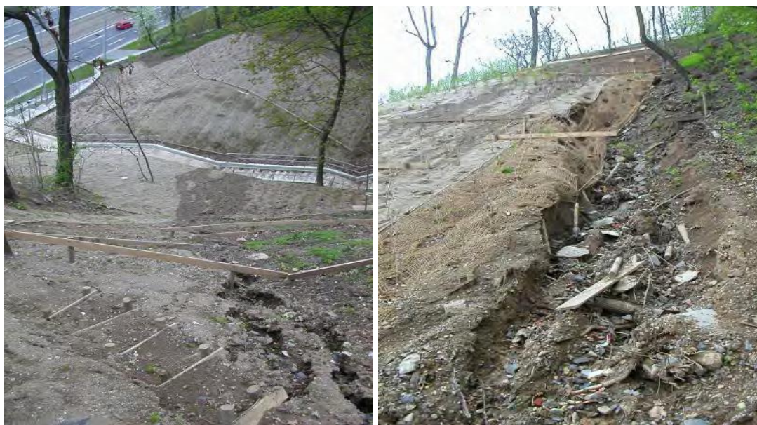
Obrázek 17a, b. Nefunkční prknování, tvorba erozní rýhy (Zlatuška 2013).
