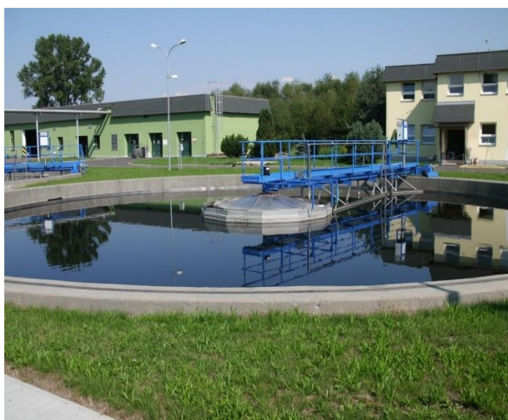
Obrázek 5.4 – Dosazovací nádrž (ČOV Strakonice, 2016)
