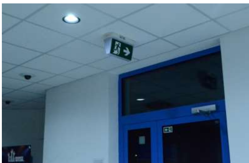
Obrázek 4 Světelné směrové označení
