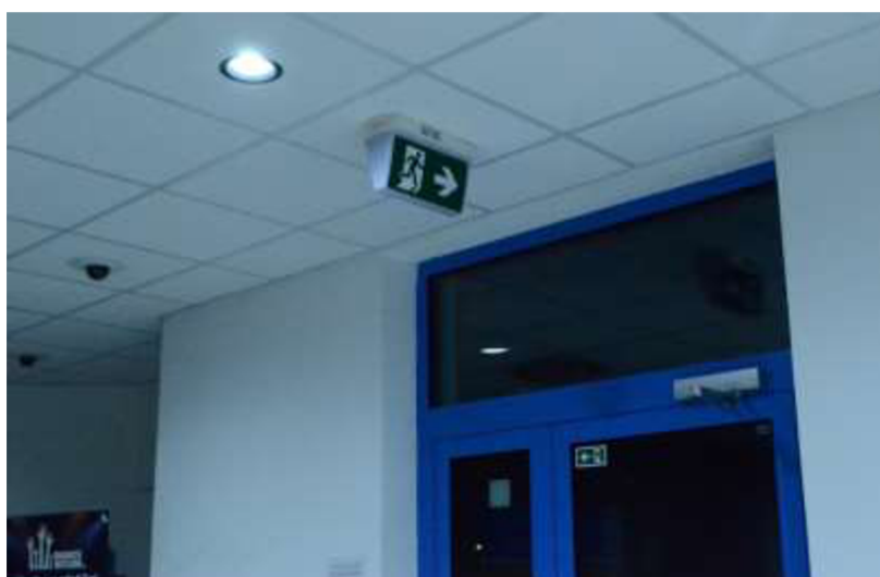
Obrázek 4 Světelné směrové označení
