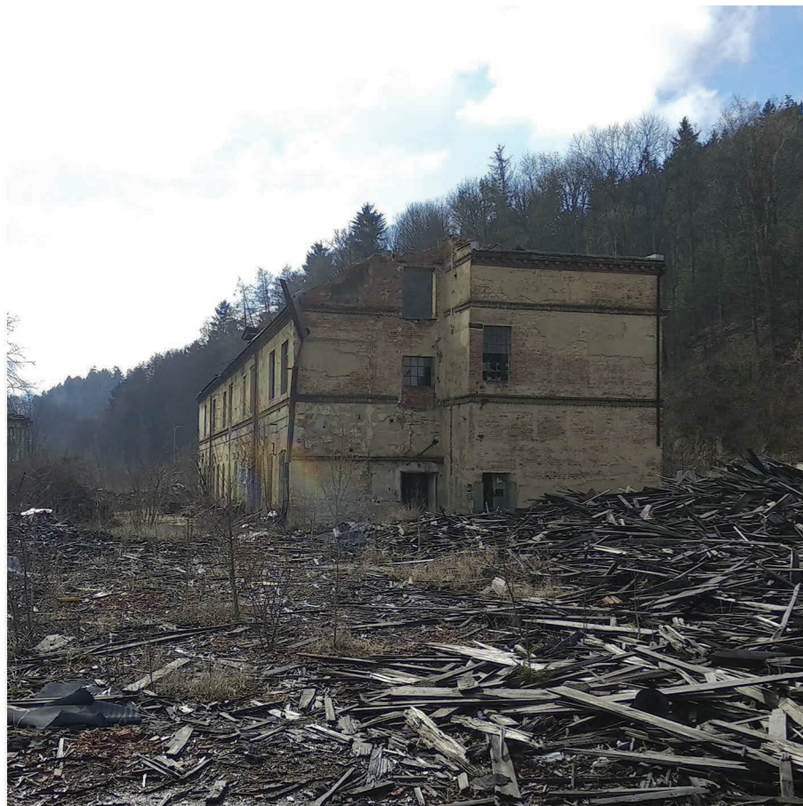
ZANEDBANÝ STAV BUDOV V JIŽNÍ ČÁSTI AREÁLU.
