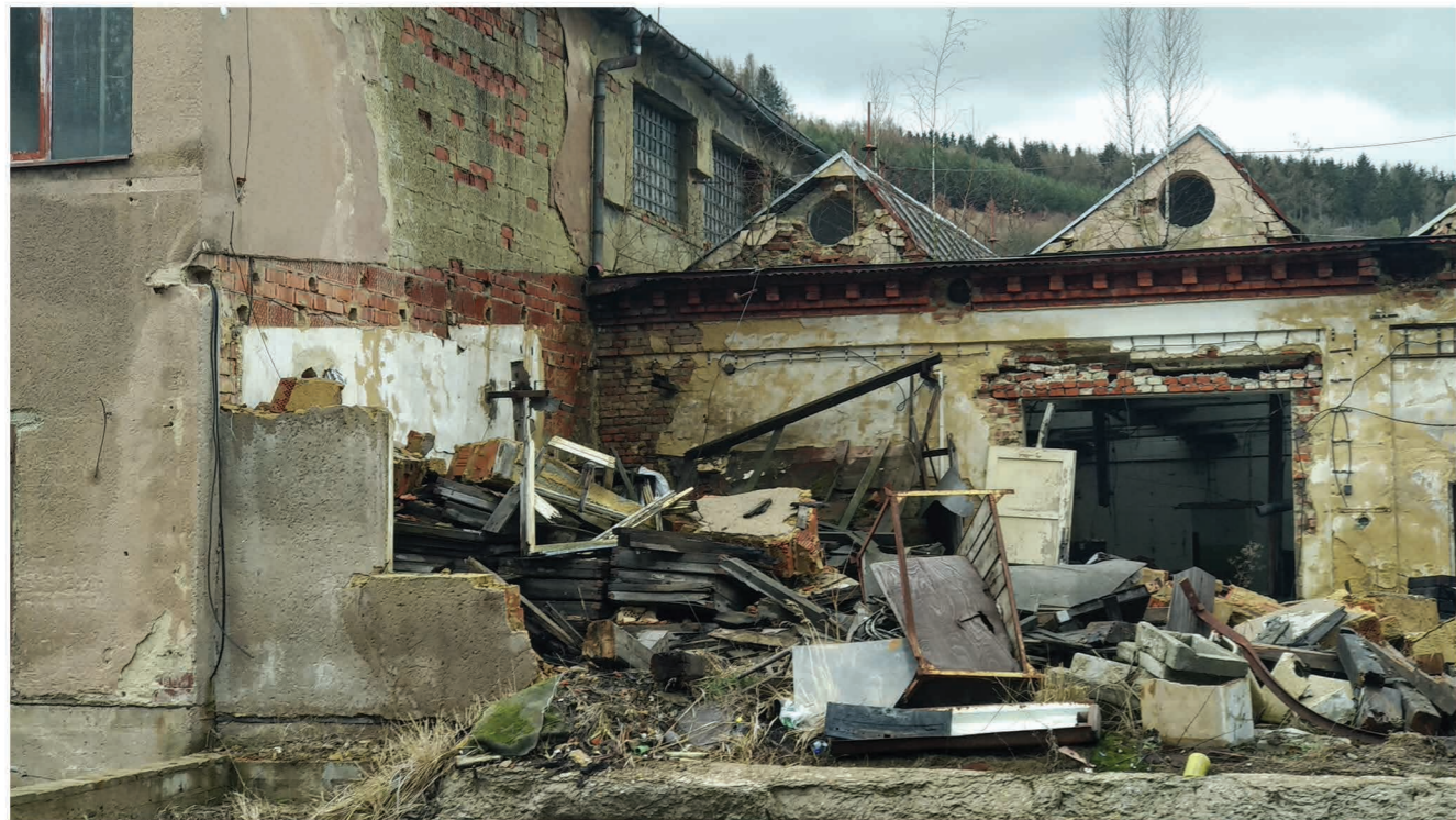
SÁL S PILOVITOU STŘECHOU JE V DEZOLÁTNÍM STAVU. ALE Z HISTORICKÉHO HLEDISKA TVOŘÍ CHARAKTER MÍSTA.
