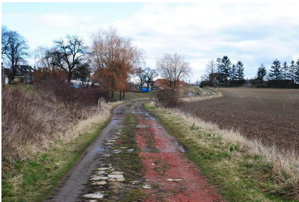
Obrázek 21: VPC5 v úseku u intravilánu, který vyžaduje rekonstrukci
