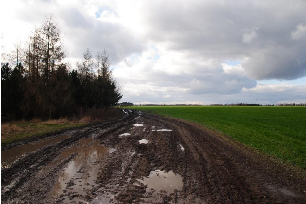
Obrázek 17: HPC7 od východu a její technický stav
