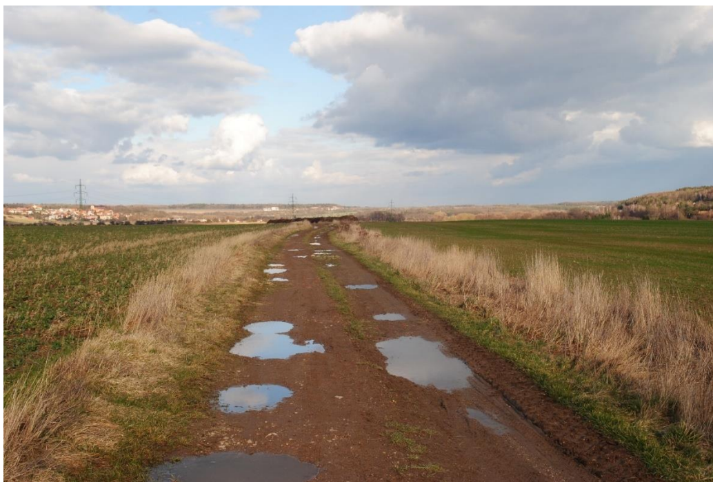
Obrázek 13: HPC3 od západu, s patrným poškozením
