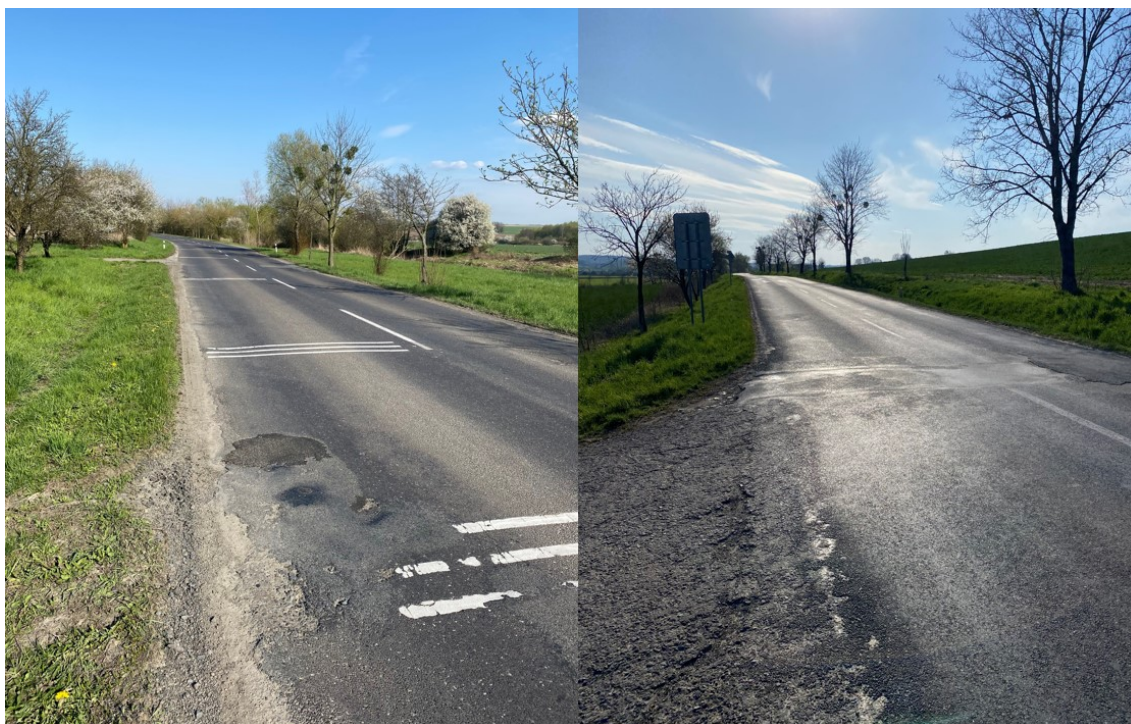
Obr. 3.10 Současný technický stav úseku silnice 150 Domaželice-Dřevohostice
