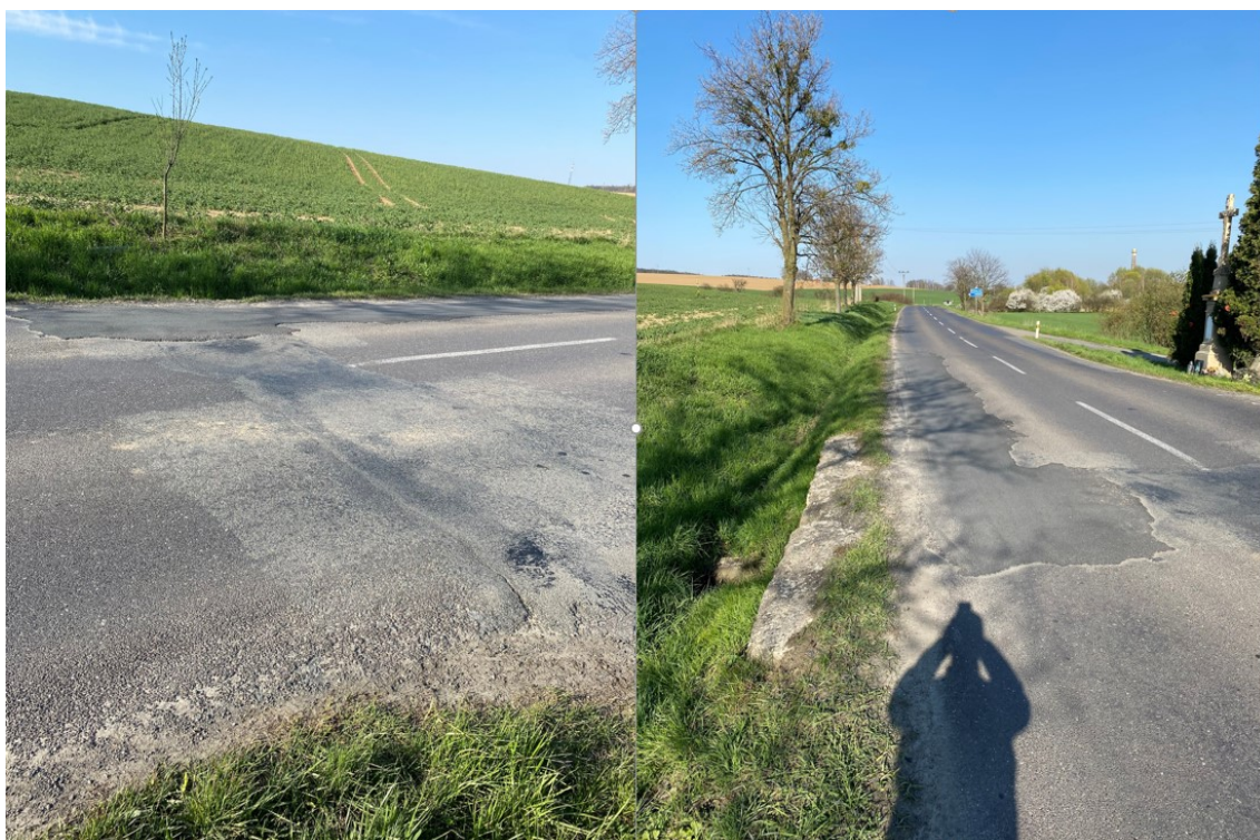
Obr. 3.11 Současný technický stav úseku silnice 150 Domaželice-Dřevohostice
