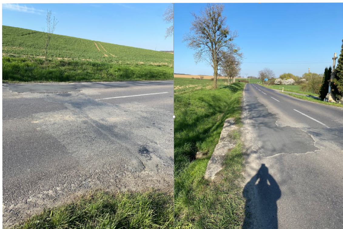
Obr. 3.11 Současný technický stav úseku silnice 150 Domaželice-Dřevohostice
