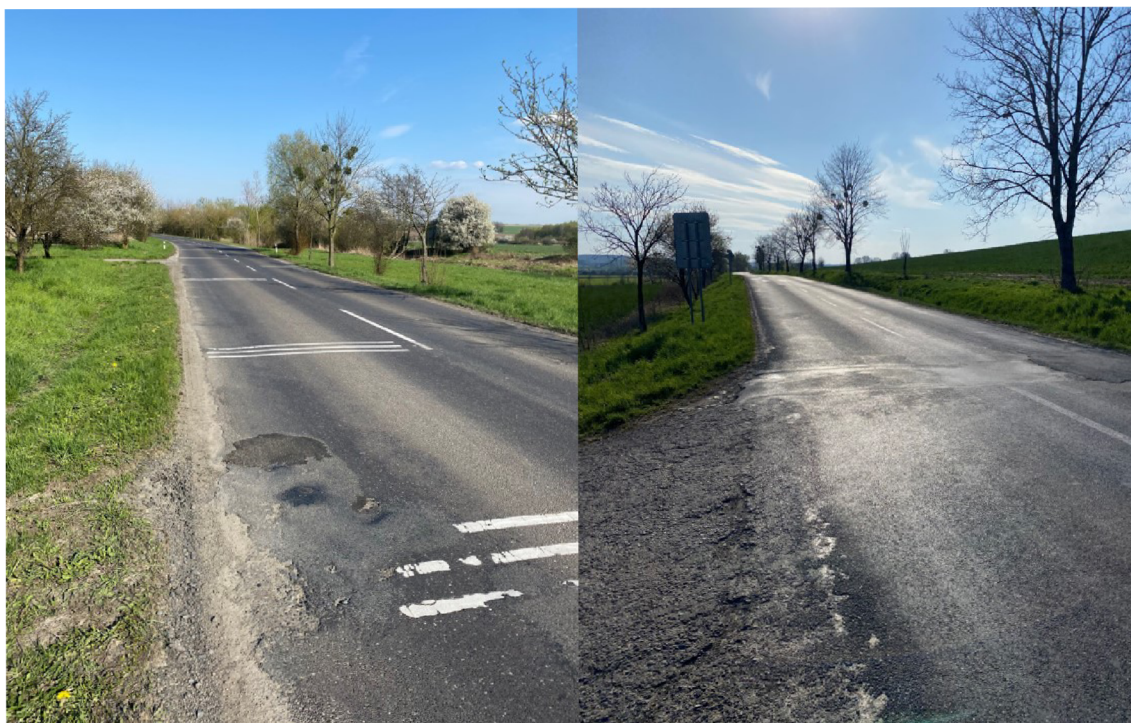
Obr. 3.10 Současný technický stav úseku silnice 150 Domaželice-Dřevohostice
