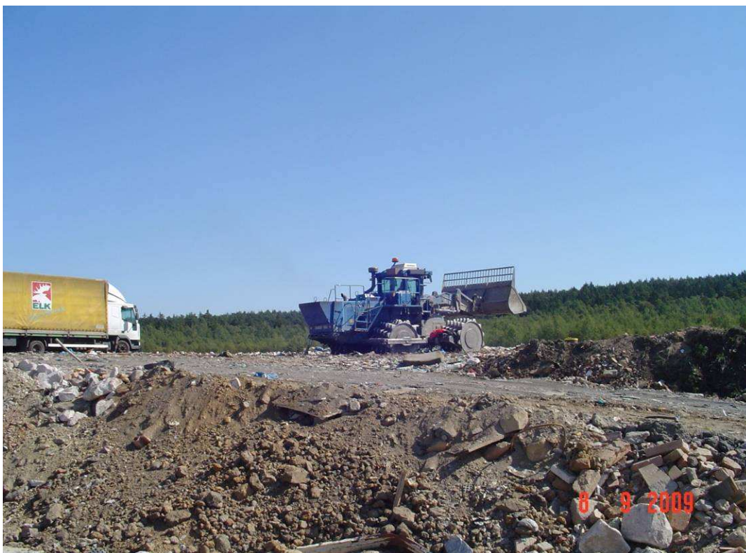
Příloha č. 6: Pohled na odpad rozhrnující kompaktor , 8. 9. 2009
