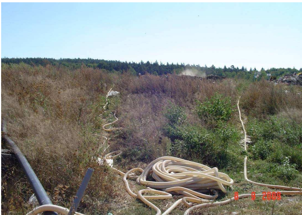
Příloha č. 11: Drenážní odplyňovací systém pro jímání skládkového plynu, 8. 9. 2009
