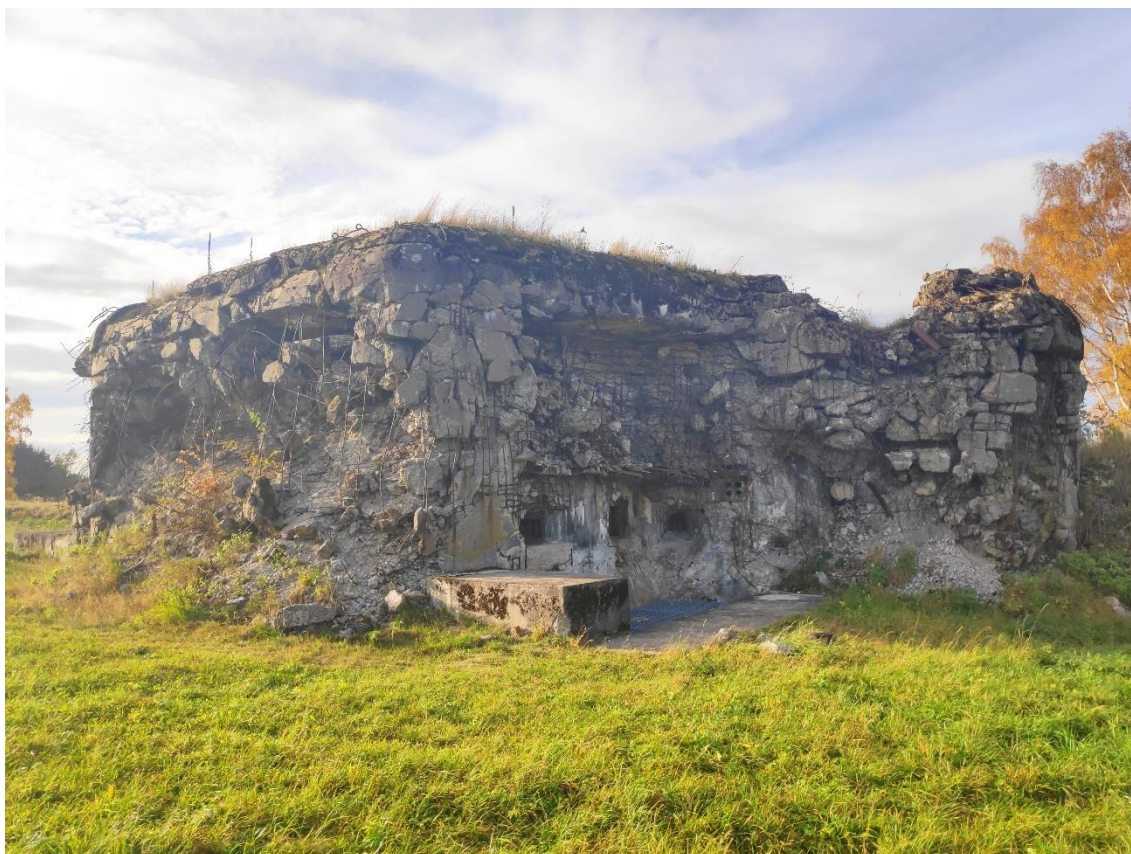
Obr. 14: Značně rozdrobený beton na týlové stěně K-Bg-S 10, v místech zásahů.
