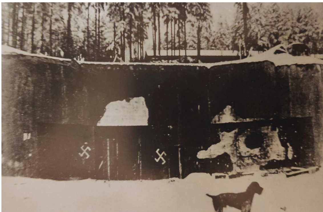
Obr. 33: K-Ba-S 22a s poškozenou omítkou, okupovaný nacisty, v zimě 1939. Zdroj: Vaňourek, M. (1999).
