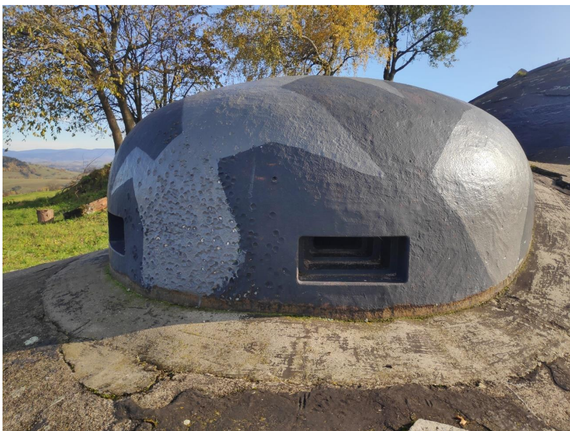
Obr. 19: Poškození pozorovacího zvonu K-Bg S12b palbou pěchotních zbraní.
