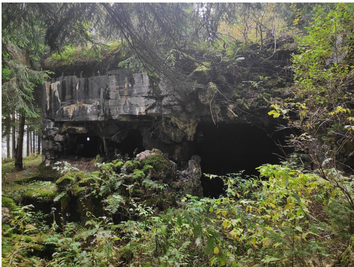
Obr. 3: Značně poškozená stěna střelecké místnosti objektu K-S 2.
