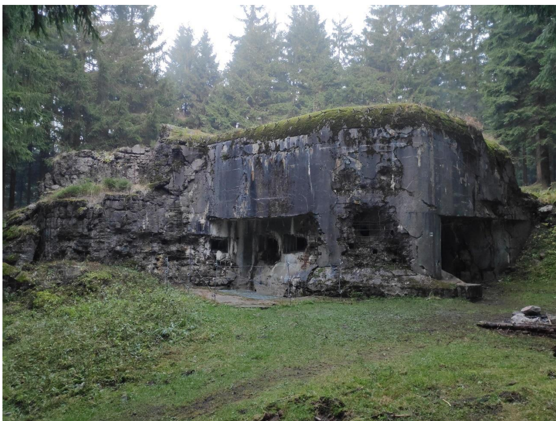
Obr. 35: Výrazné horizontální praskliny těsně nad úrovní terénu, jako pozůstatek mohutných náloží odpálených u základů K-Ba-S 24.
