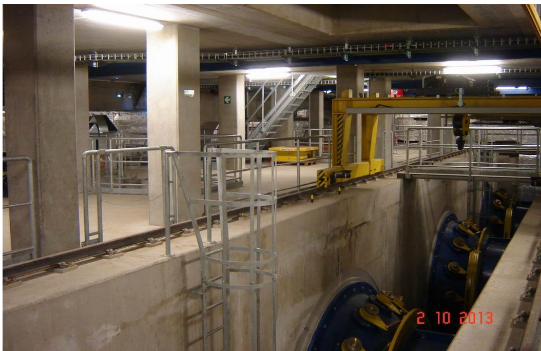
Obr.55 Strojovna MVE Roudnice nad Labem [29]
