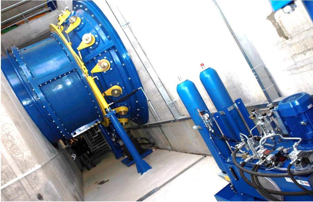
Obr.60 Strojovna MVE Lovosice - Píšťany [32]
