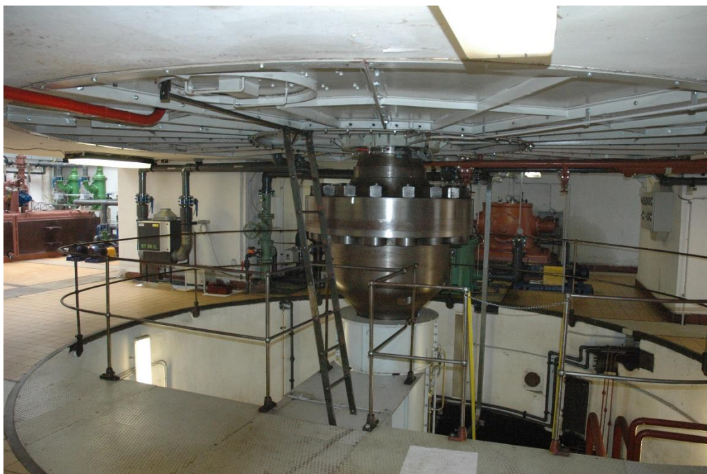
Obr.63 Pohled do strojovny na Kaplanovu turbínu
