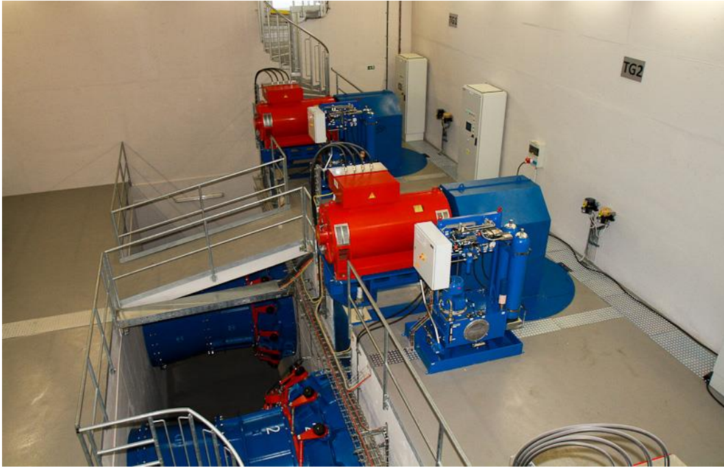
Obr.23 Strojovna MVE Velký Osek – pohled na dvě Kaplanovy turbíny [12]
