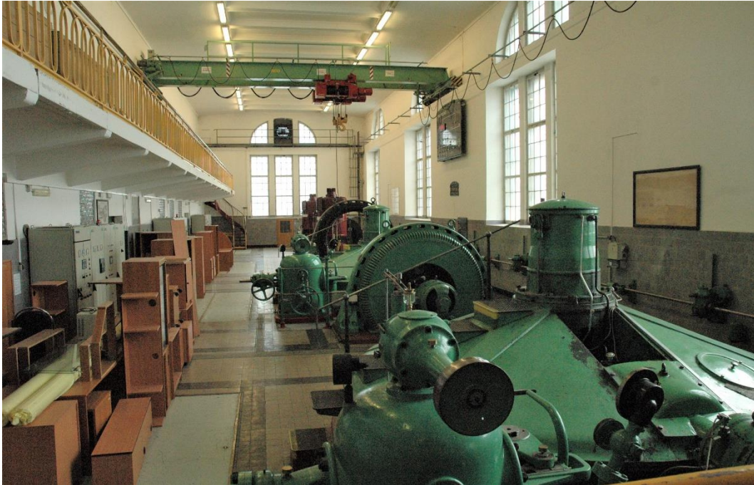
Obr.9 Strojovna MVE Přelouč
