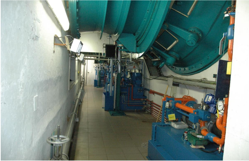
Obr.47 Pohled na část strojovny pod turbínami
