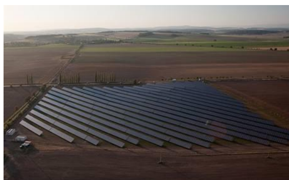
Obr. 44: Fotovoltaická elektrárna ve Smiřicích
