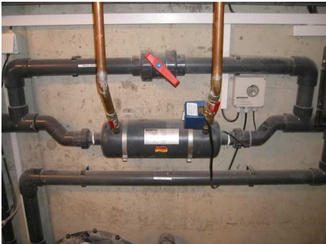
Obrázek č. 12– průtokový ohřivač vody rodinného bazénu Zdroj: fotodokumentace Sportakcent
