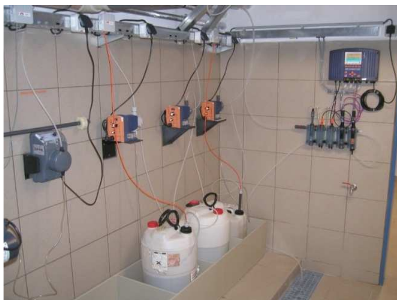
Obrázek č.14 - chemické hospodářství – napojení na automatickou stanici. Zdroj: fotodokumentace Sportakcent.
