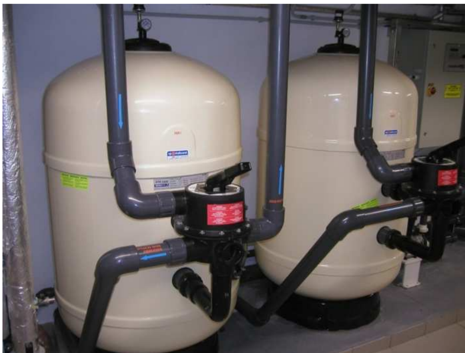
Obrázek č. 10 – filtrační zařízení pro velký veřejný bazén. Zdroj: fotodokumentace Sportakcent
