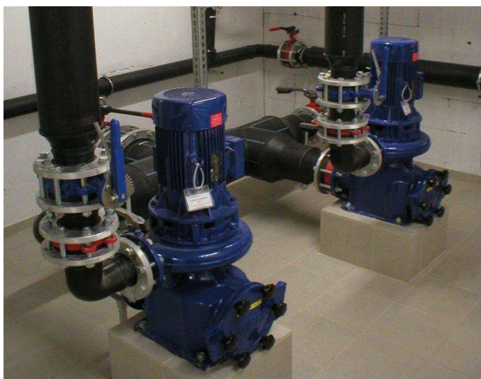
Obrázek č.9 – cirkulační čerpadla pro velký veřejný bazén. Zdroj: fotodokumentace Sportakcent
