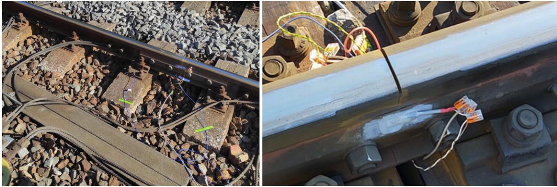
Obrázek 67: Monitorování lepeného izolovaného styku
