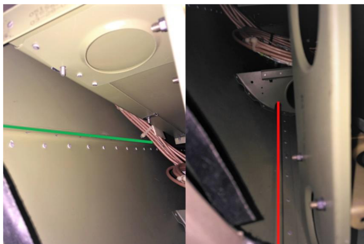
Obrázek 49: Fotografie vnitřní části trupu letounu Cessna 172 (levá: zeleně stringer s L profilem, pravá: červeně stringer s C profilem)
