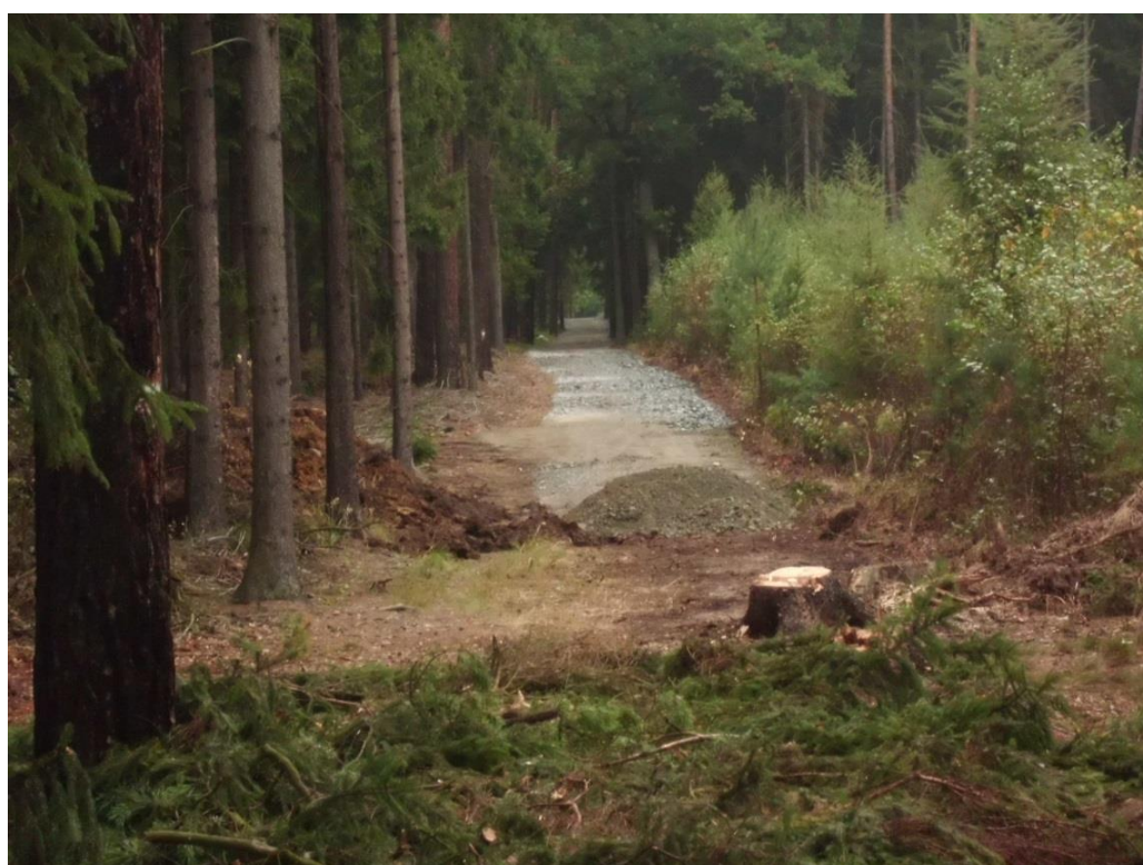
Obrázek 22 Rozšiřování lesních cest - severovýchodní část lesa
