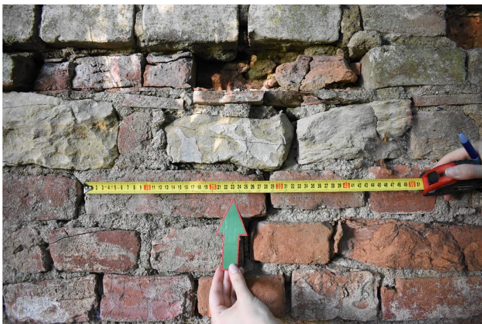
Tabulka 81: Foto cihlové zdi na jedné z hospodářských budov u zámku (autor: K. Pellarová).
