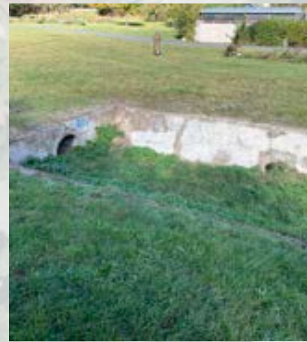
Obr. 111 Vústění potrubí pod ulicí Oistrachova, vedené z Panské zahrady + vyústění dešťové kanalizace, zdroj: autorka práce
