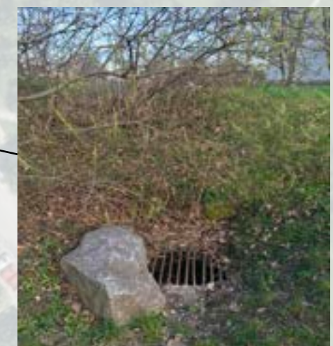
Obr. 110 Horská vpus s potrubím vedené do Centrálního parku, zdroj: autorka práce
