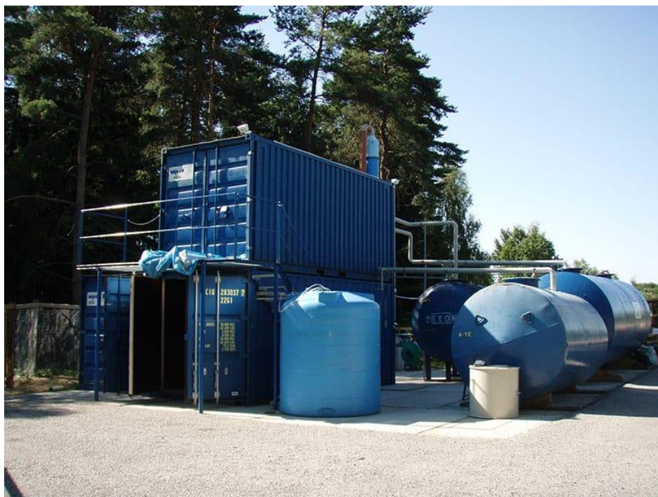
Obrázek č. 26: Sanační centrum s reverzní osmózou (Lidařík, ©2021)
