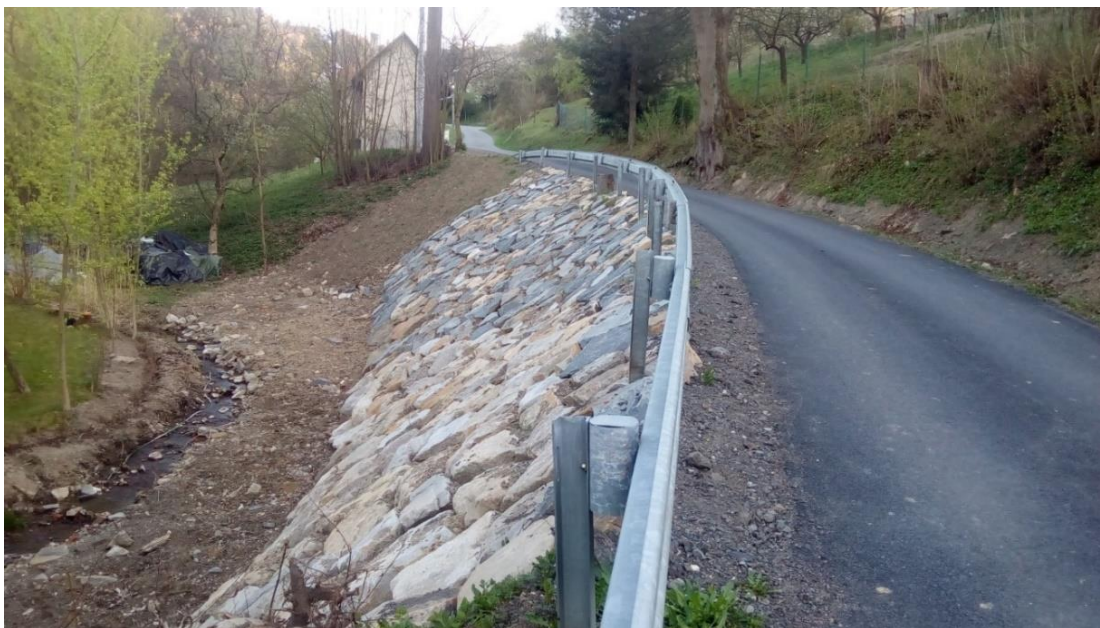
Obrázek 24: zpevněný břeh a opravená silnice po posledním sesuvu v severní části lokality 33. Vlastní foto, 20. 4. 2019
