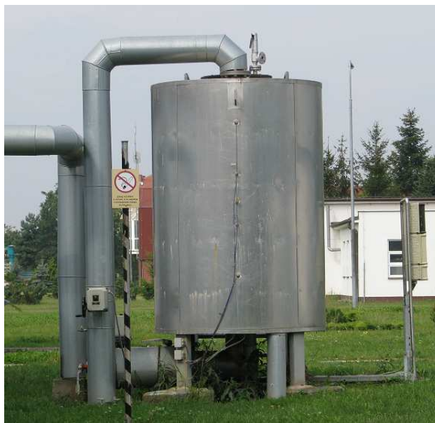
Obr. 6.0 Odsiřovací jednotka Suloff - ČOV Prostějov
