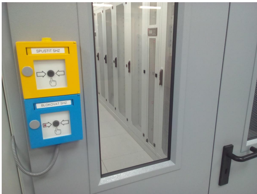
Obrázek 23 - Ovládání SHZ v serverovně HC8, ZDROJ: vlastní
