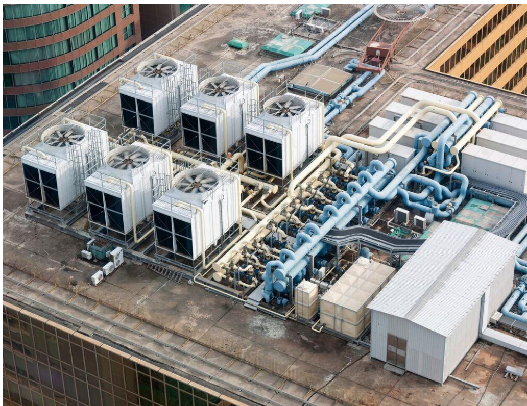
Obrázek 4 - Chillery umístěné na střeše datového centra[19]
