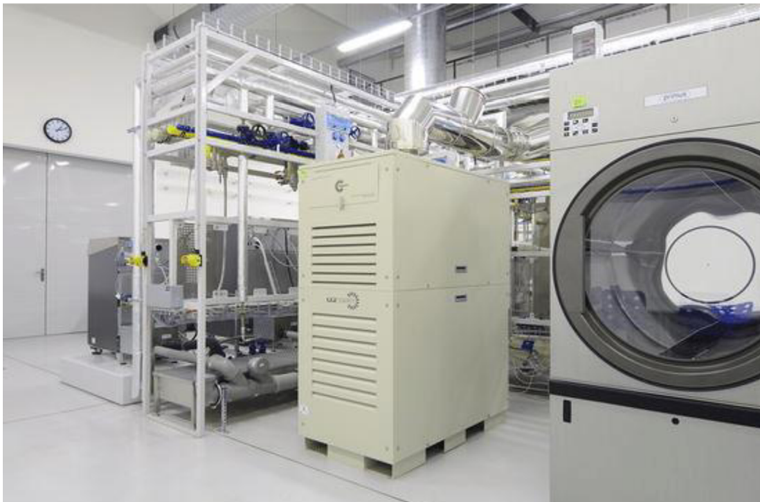
Obr. 1 Mikroturbína Capstone C30 integrována do infrastruktury LENP
