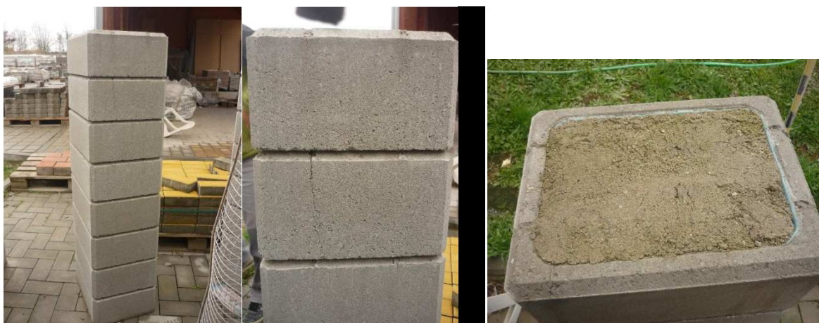
Obrázek 3.5: Výběr z fotodokumentace poruch zdících prvků
