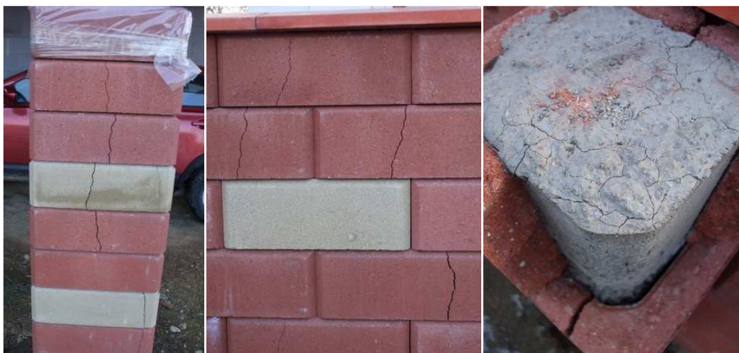
Obrázek 3.2: Výběr z fotodokumentace poruch zdících prvků [6]
