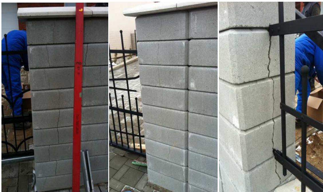
Obrázek 3.4: Výběr z fotodokumentace poruch zdících prvků [8]
