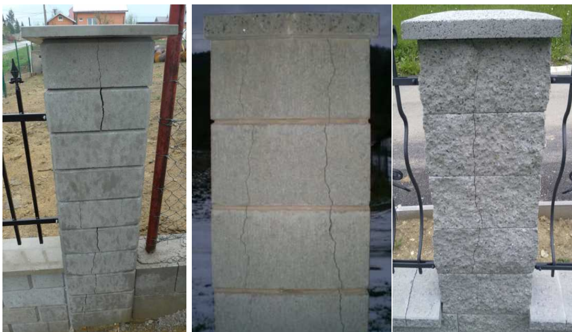
Obrázek 3.1: Výběr z fotodokumentace poruch zdících prvků – zastoupeny jsou typické poruchy
