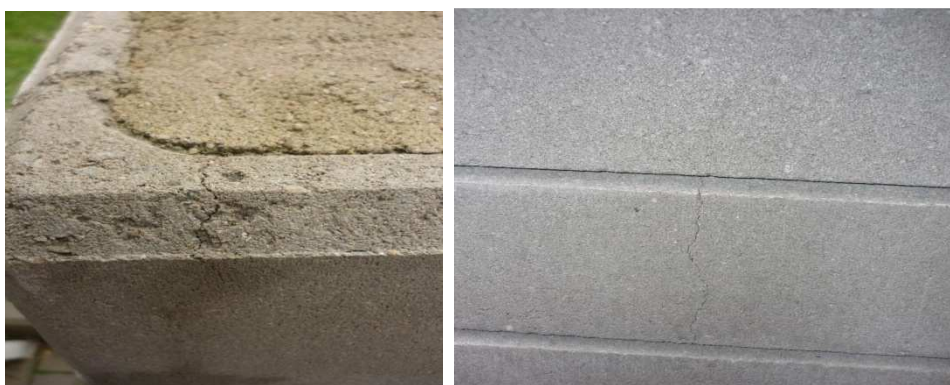
Obrázek 3.6: Výběr z fotodokumentace poruch zdících prvků
