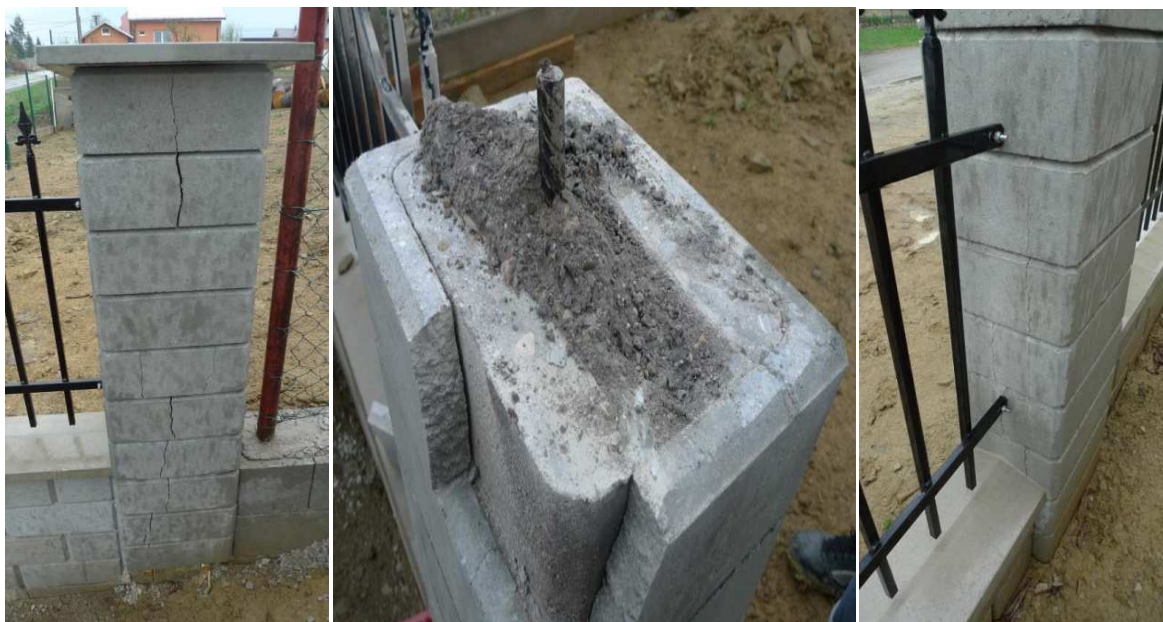
Obrázek 3.3: Výběr z fotodokumentace poruch zděicích prvků [7]
