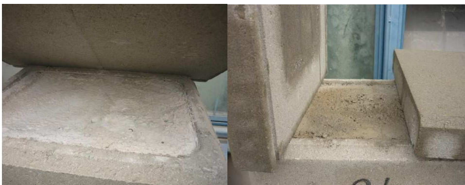
Obrázek 3.8: Výběr z fotodokumentace, vliv spojení zákrytové desky na zatékání vody
