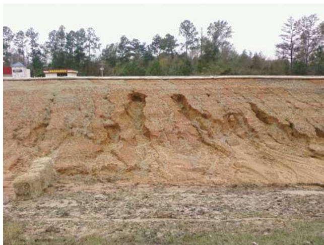
obrázek 4 Eroze silničního náspu ( http://www.landscapeonline.com/research/lasn/2011/02/img/ECT/ECT-9.jpg )
