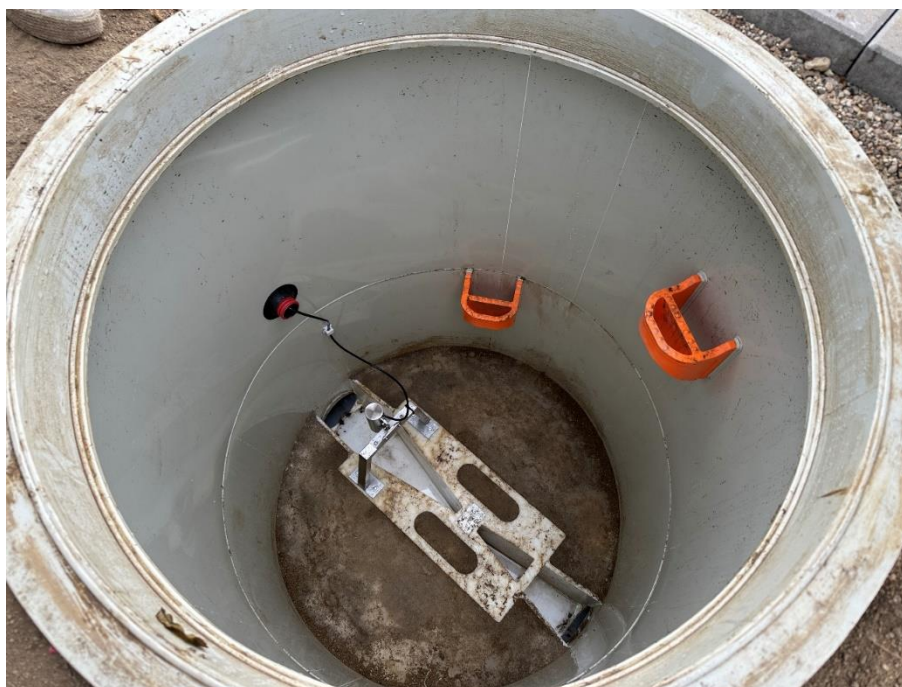
Obr. 33 – Parshallův žlab, měrný objekt, školní exkurze (obec Hlína)
