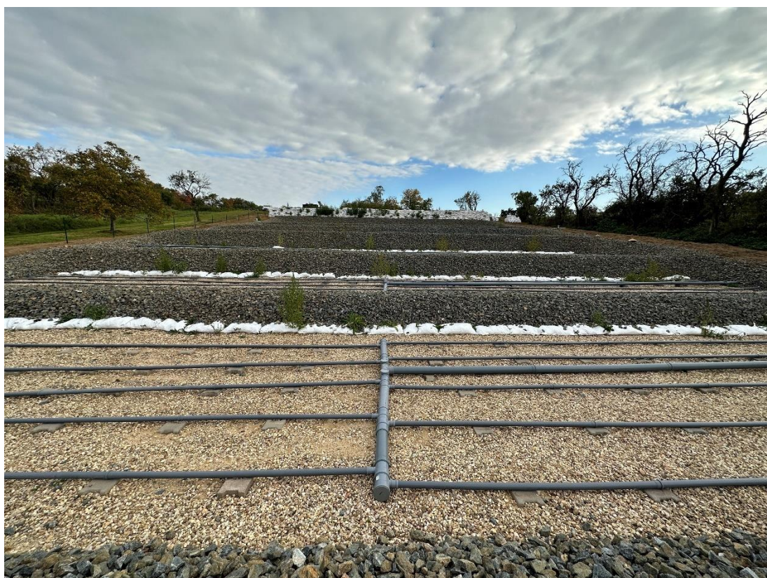
Obr. 17 - Distribuční potrubí: 2. stupeň
