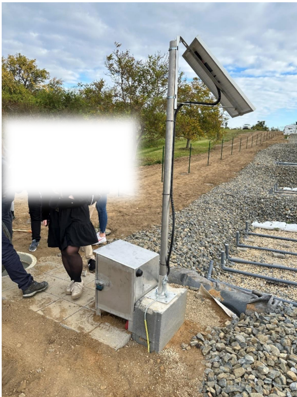
Obr. 34 - Ukázka zapojení MaR pro ŘJ s GSM modulem k měrnému objektu, školní exkurze (obec Hlína)
