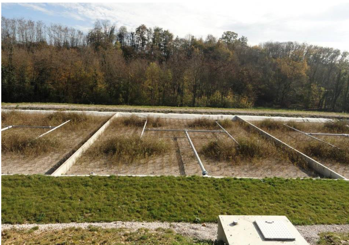
Obr. 15 - Distribuční potrubí: 1. stupeň (2) [18]
