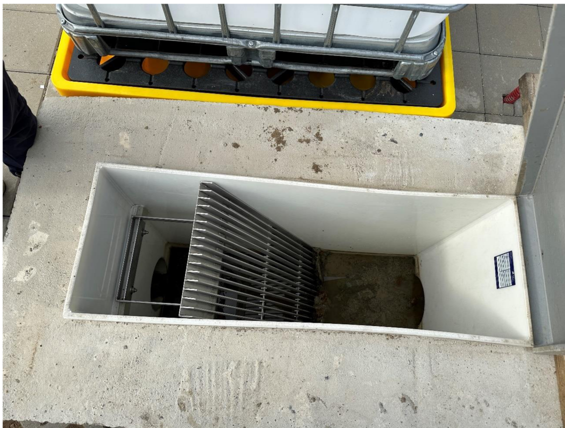
Obr. 28 - Ručně stírané česle, školní exkurze (obec Hlína)
