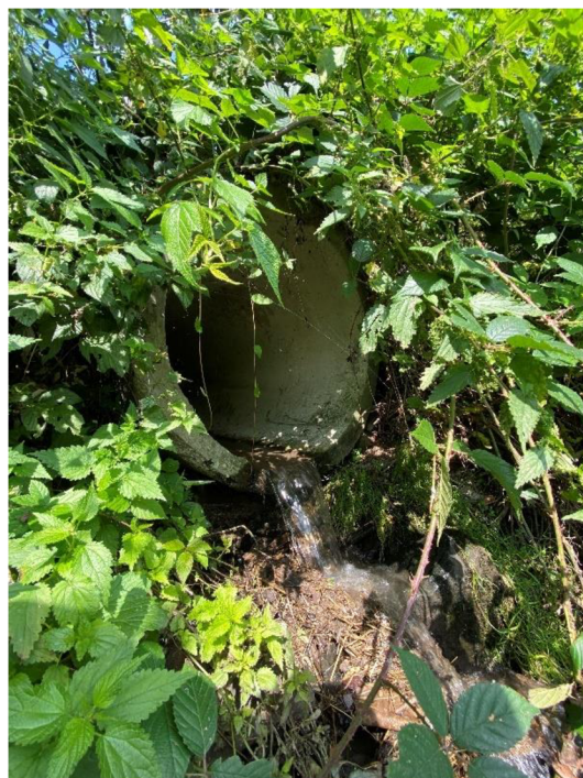
Obr. 6 – Jedna z výústí stávající kanalizační sítě v obci Skřipov
