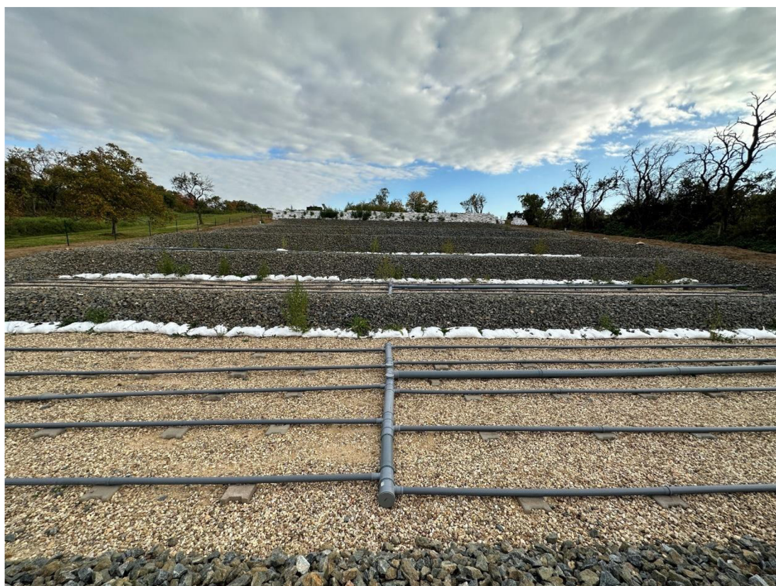
Obr. 17 - Distribuční potrubí: 2. stupeň
