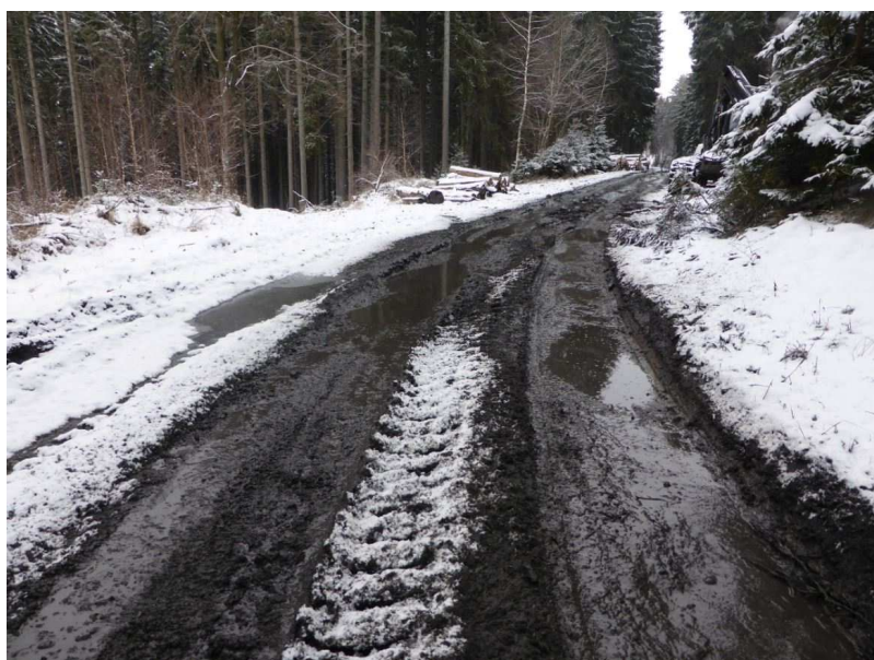
Obrázek č. 4 – Zničená LC provozem před rekonstrukcí – foto Martin Váško
