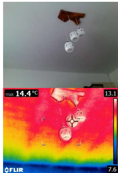
Obrázok 1: termosníмка stropu (Zdroj – autor)
