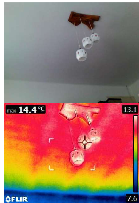
Obrázok 1: termosníмка stropu (Zdroj – autor)
