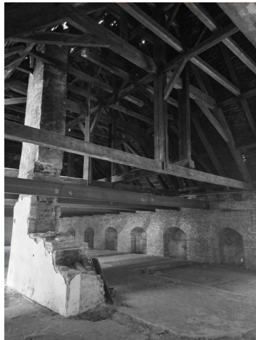
Obr.41 foto vlastní třetí patro otevřené do krovu, původní stěna zbořená, zůstal pouze komín, krov ztužen
