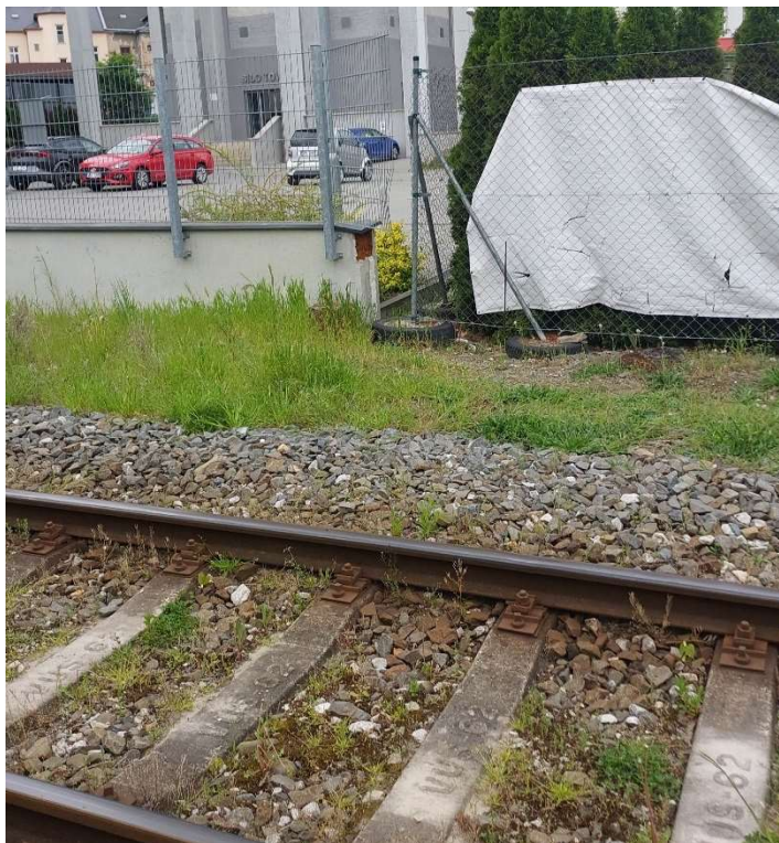
Obrázek 10 – Přechod č.3 - díra v plotě
