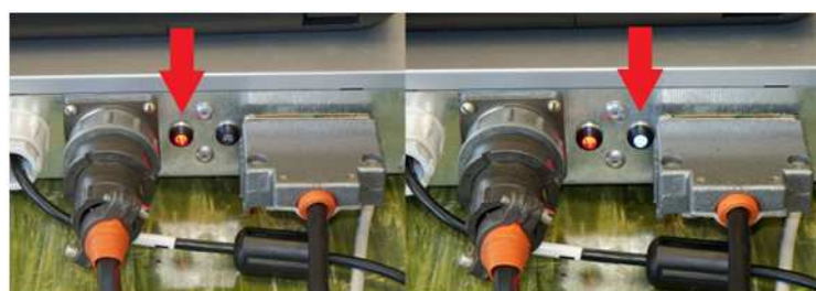
Obrázek 67 Panel kontrolních světel LED
