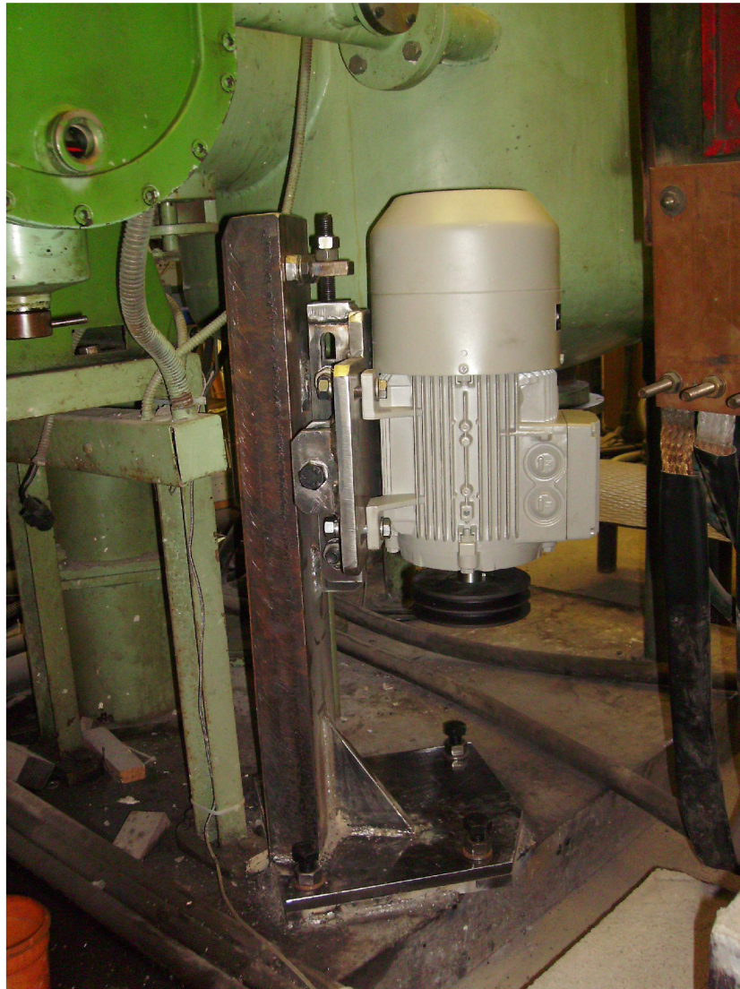
Obr.25: Pohled na uložení hnacího motoru
